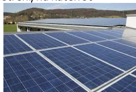
Streha z nameščenimi fotovoltaičnimi celicami
