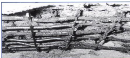
Poškodovana armiranobetonska konstrukcija
