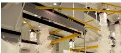
Vgrajeni gasilni sistemi s peno
