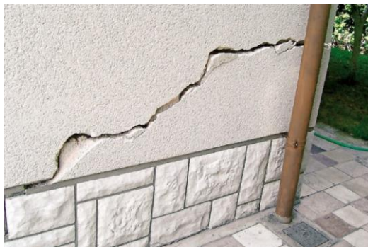
Poškodba objekta zaradi neenakomernega posedanja temeljev
