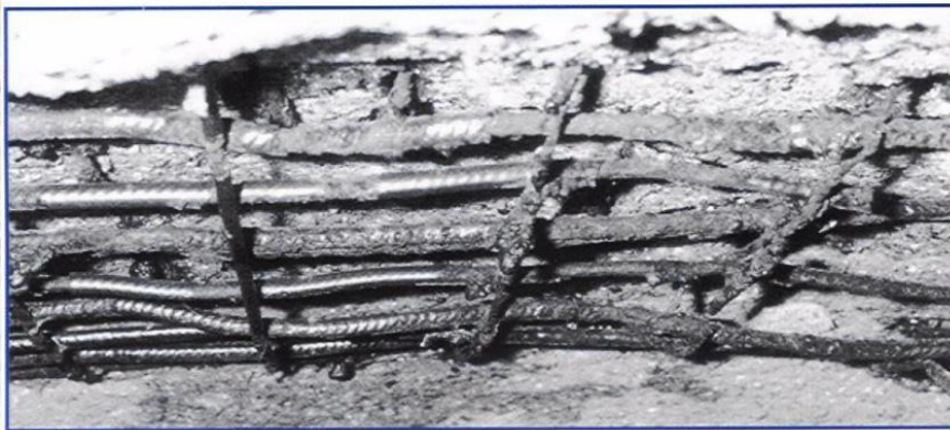
Poškodovana armiranobetonska konstrukcija
