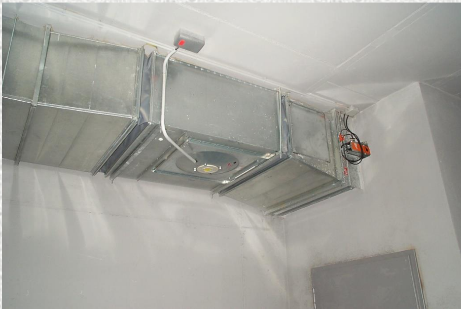
Mehanski odvod dima in toplote
